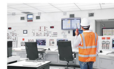
工业控制机房
