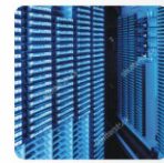
大型数据中心机房
