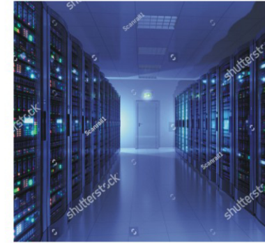
集装箱数据中心
