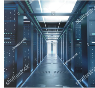
模块化数据机房
